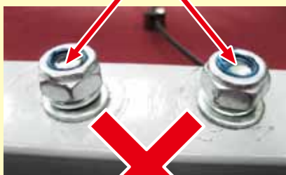
緩みがあるナット締付け状態 (凹んでいる状態)
